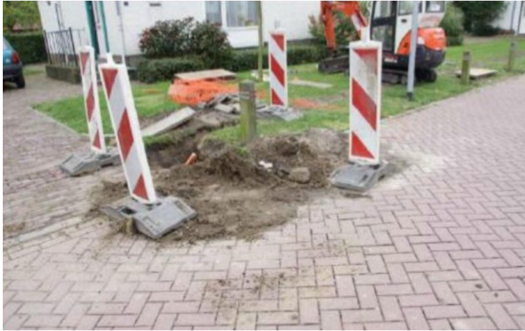
Figuur 6-3: Vervuiling van de verharding door werkzaamheden
